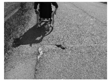
写真5 道路の割れ目 2014年10月24日撮影
