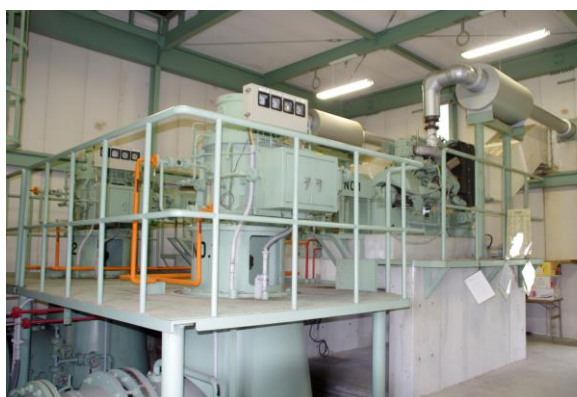
写真 2 加古川西土地改良区管理の排水機場
