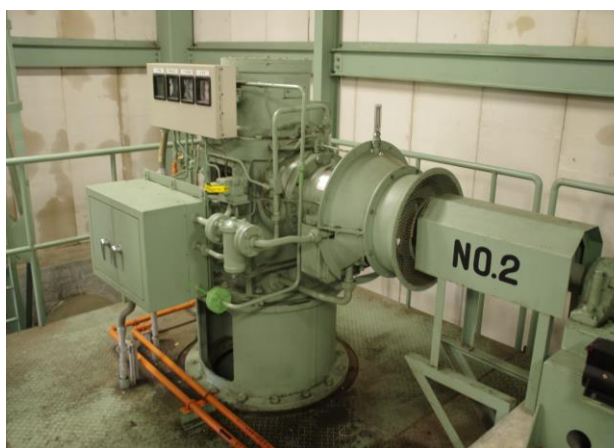
写真4 加古川西土地改良区の排水機場 2018年9月8日阪口撮影
